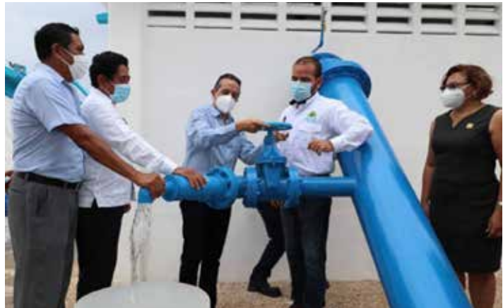
EL GOBERNADOR DE QUINTANA ROO ENTREGÓ A FAMILIAS DE CALDERITAS LAS OBRAS DE SECTORIZACIÓN, SUSTITUCIÓN DE TUBERÍAS Y MICROMEDICIÓN DEL SECTOR DE DISTRIBUCIÓN DE AGUA POTABLE.
