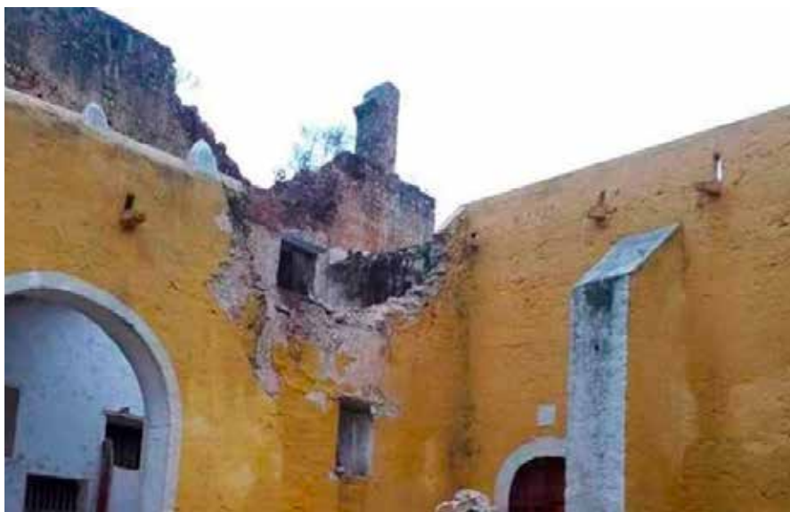
En Tekantó se informó del derrumbe de la torre trasera de la iglesia de esa población debido al reblandecimiento del material de esa edificación.
